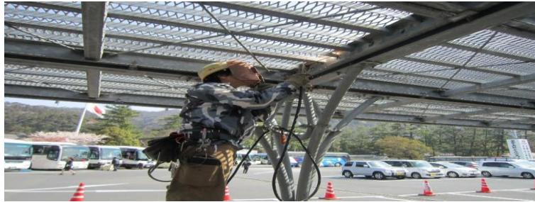
ボルト点検、さびが付着している箇所のは正
